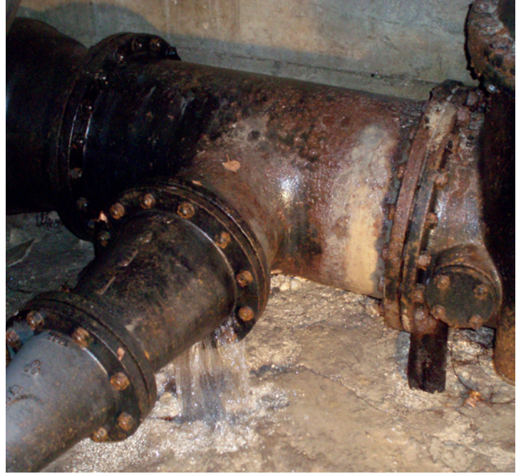
Durch Korrosion werden Leitungen schleichend zerstört.
